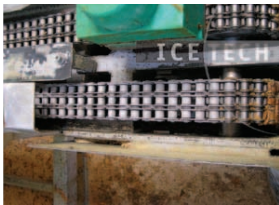
Rengöring med kolsyreis sker under drift. Tänk på att smörja kedjorna efter rengöring.
