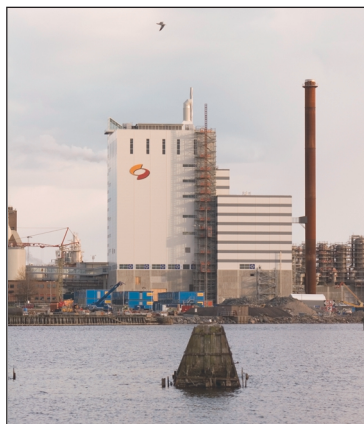
CTMP-anläggningen vid Stora Enso Skogshalls bruk.
